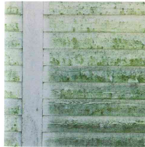
Figur 89 Facade med belægning af grønalger.
